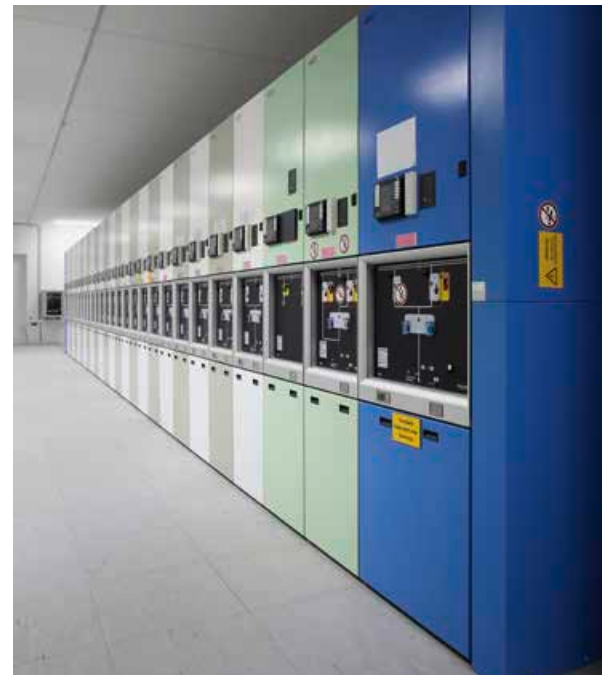
Blick auf die Leistungsschalter in der neuen Trafostation.
